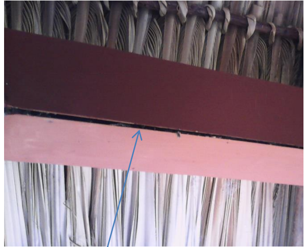
Viga de perlin cubierta con plycem, con signos de corrosión
