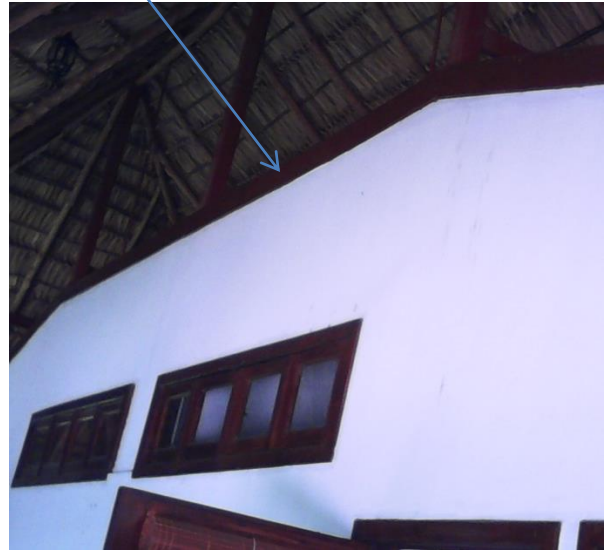
Pared sin viga de perlin
