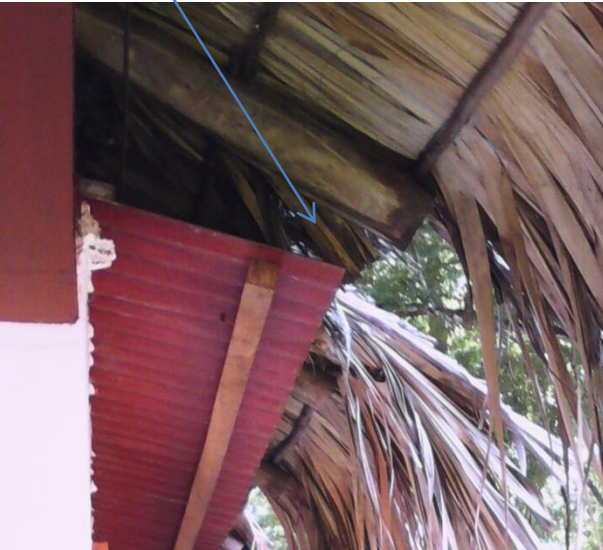
Aleros sin canales y en mal estado
